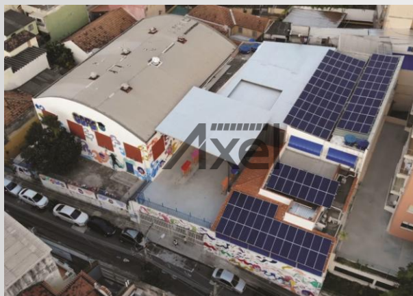
ESCOLA SEFA - MÉIER 51,48KWP (156 PLACAS)
